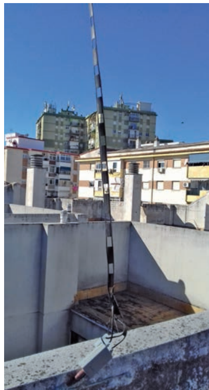
6. Un transformador de impedancias une el cable bifilar de 450 ohmios de la Western HF-10 de EA7HAE con el coaxial que baja a la estación
