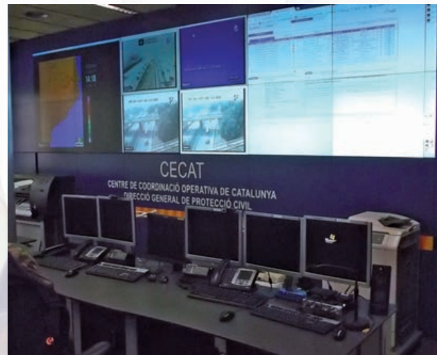
Fig. 8. Sala de Control del CECAT
